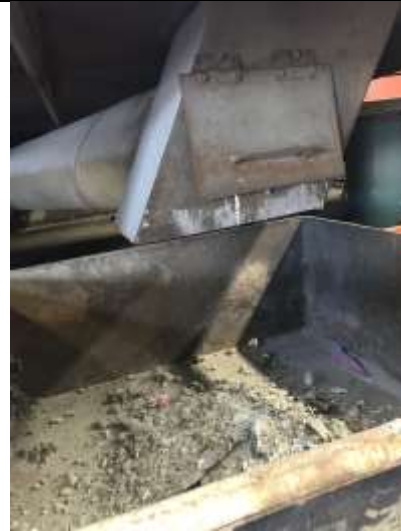
除气扒渣工位下工位（扒渣废气）集气口
