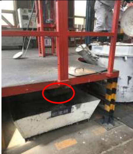
除气扒渣工位下工位（扒渣废气）集气口
