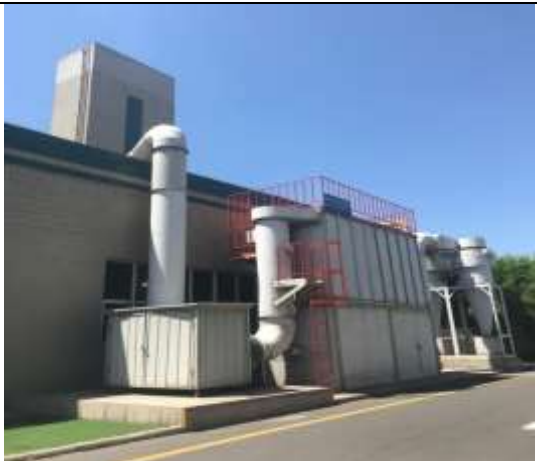
图 7 裘灰车间布袋除尘器
