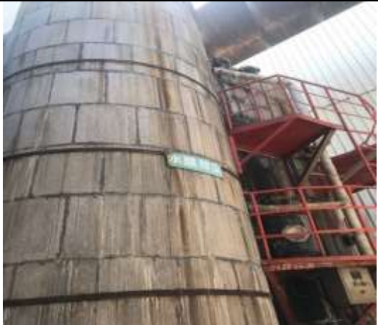
图 3 麻石水膜除尘装置
